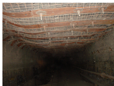
Рис. 5. Состояние кровли 157-го штрека шахты «Степная»
